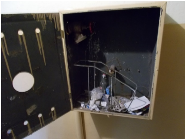
Niesprawny hydrant wewnętrzny
