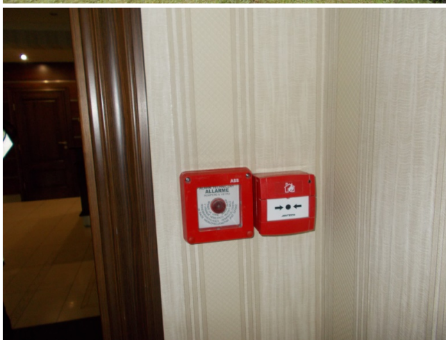
Brak oznakowania urządzeń przeciwpożarowych
