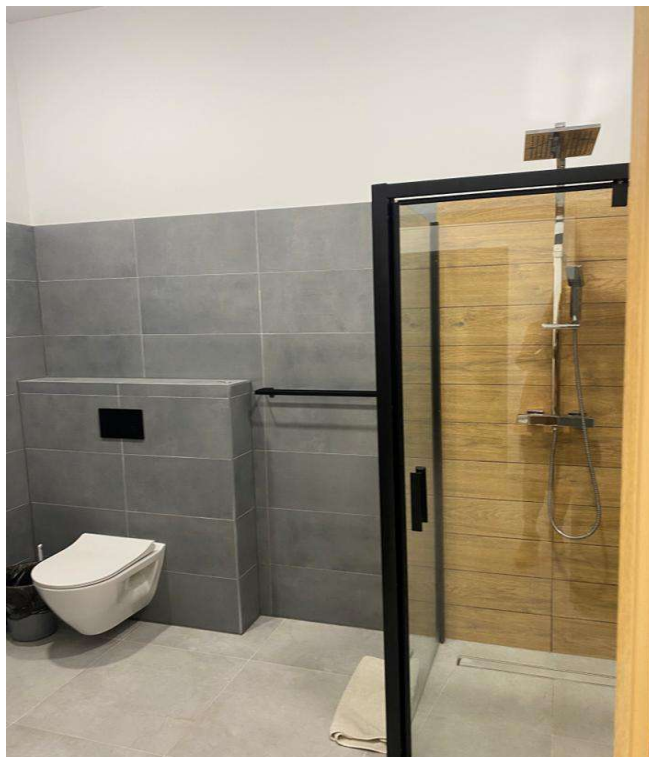
Pomieszczenie sanitarne przy warsztatach w Młodzieżowym Ośrodku Socjoterapii w Gołańczy Fot. Agnieszka Winięcka
