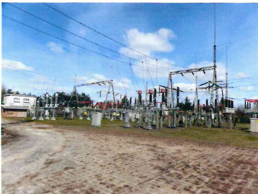
Stacja elektroenergetyczna 110/15 kV GPZ Wągrowiec (Fot. EkoAtom)
