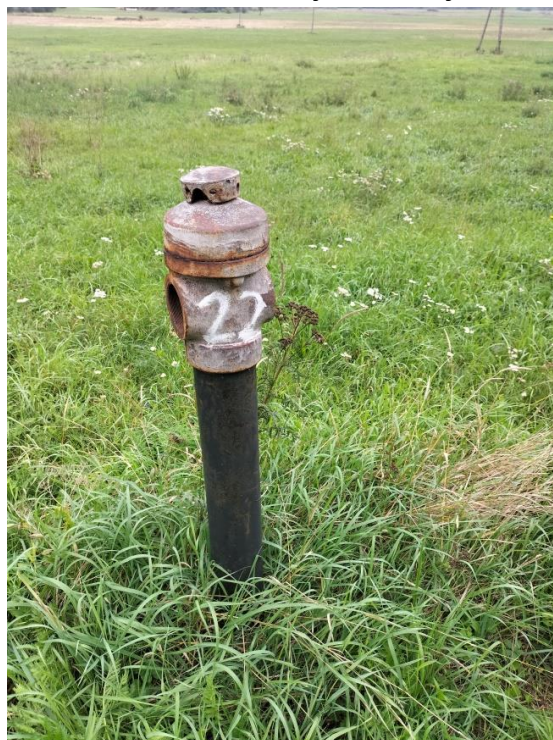
Kontrola sieci hydrantowej
